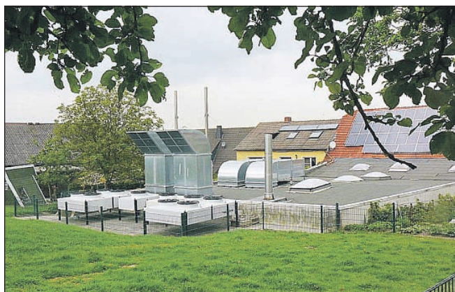
Von außen ist nicht viel zu sehen: Das Herzstück des Nahwärmenetzes, die beiden Satelliten-BHKW, sind in einer alten Gewerbehalle untergebracht. Damit die Anwohner vor Lärm geschützt sind, wurden sie doppelt schallisoliert.
