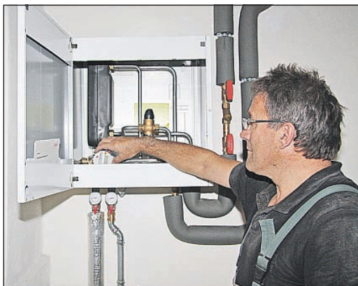
Mithilfe eines Wärmetauschers wird die Wärme aus dem Nahwärmenetz an die Haushalte übergeben.
